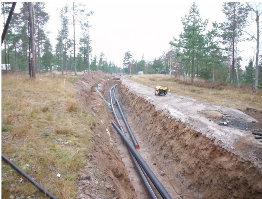
Rör för VA svetsas. Ännu har inte beslut tagits om fiber.2015-11-25 Foto I.Lindin
